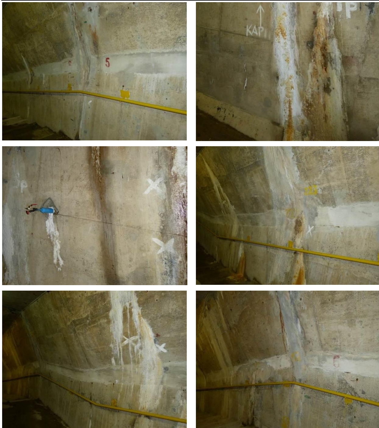
Fot. 3.6. Widok na stan techniczny sekcji nr 6 konstrukcji galerii kontrolno-zastrzykowej
