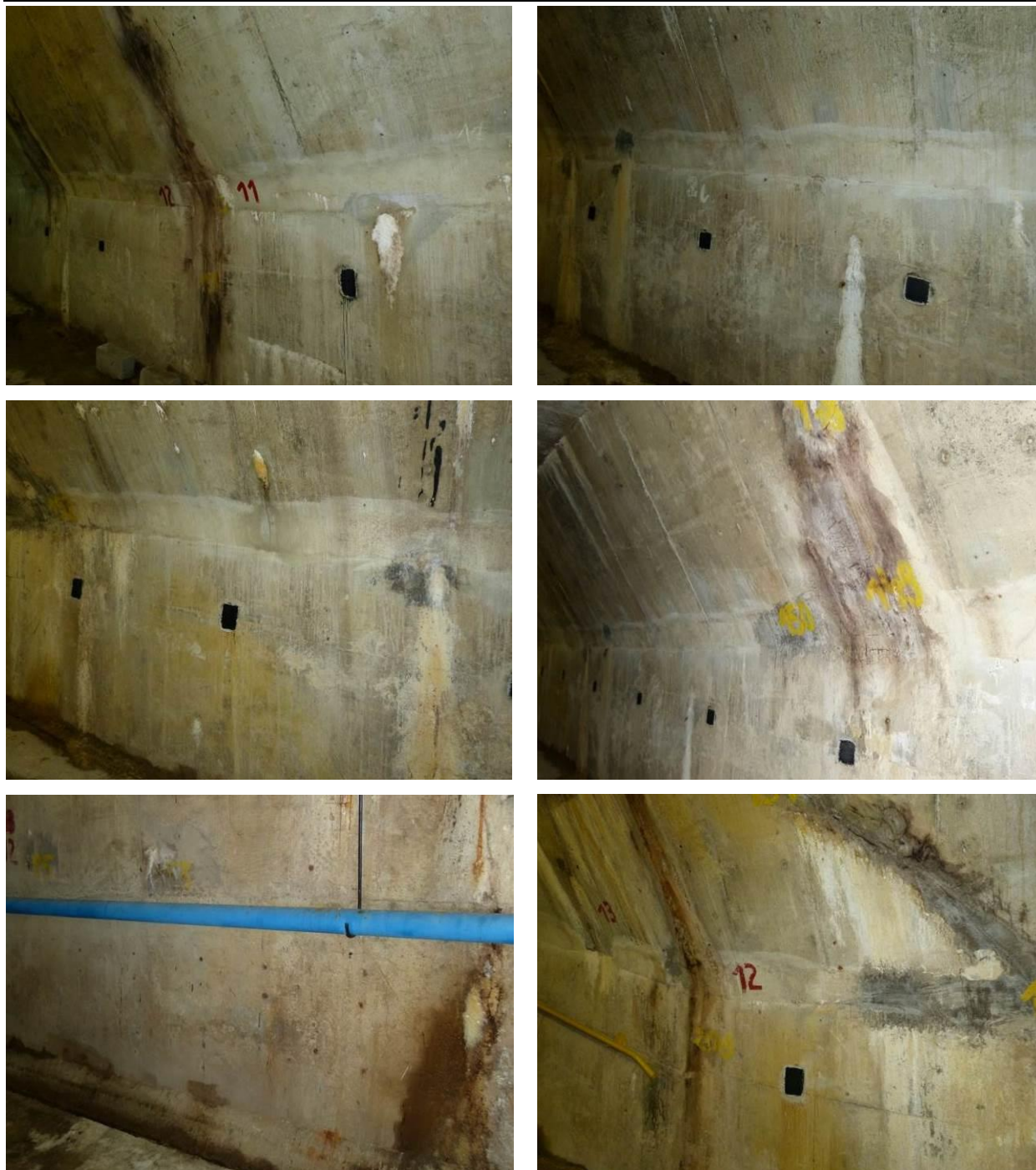
Fot. 3.12. Widok na stan techniczny sekcji nr 12 konstrukcji galerii kontrolno-zastrzykowej
