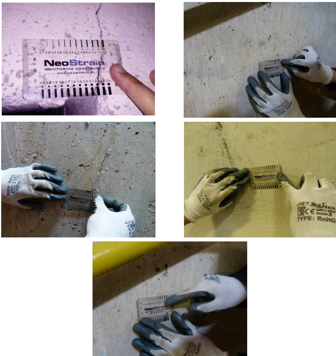
Fot. 4.3. Przykładowy widok pomiaru rozwartości występujących zarysowań
