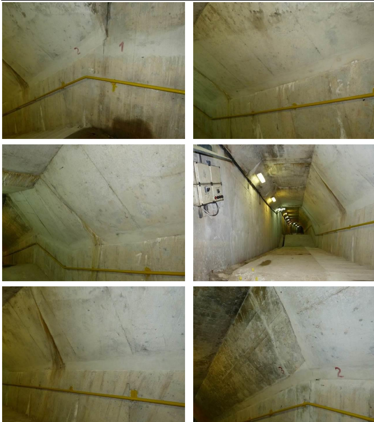
Fot. 3.2. Widok na stan techniczny sekcji nr 2 konstrukcji galerii kontrolno-zastrzykowej
