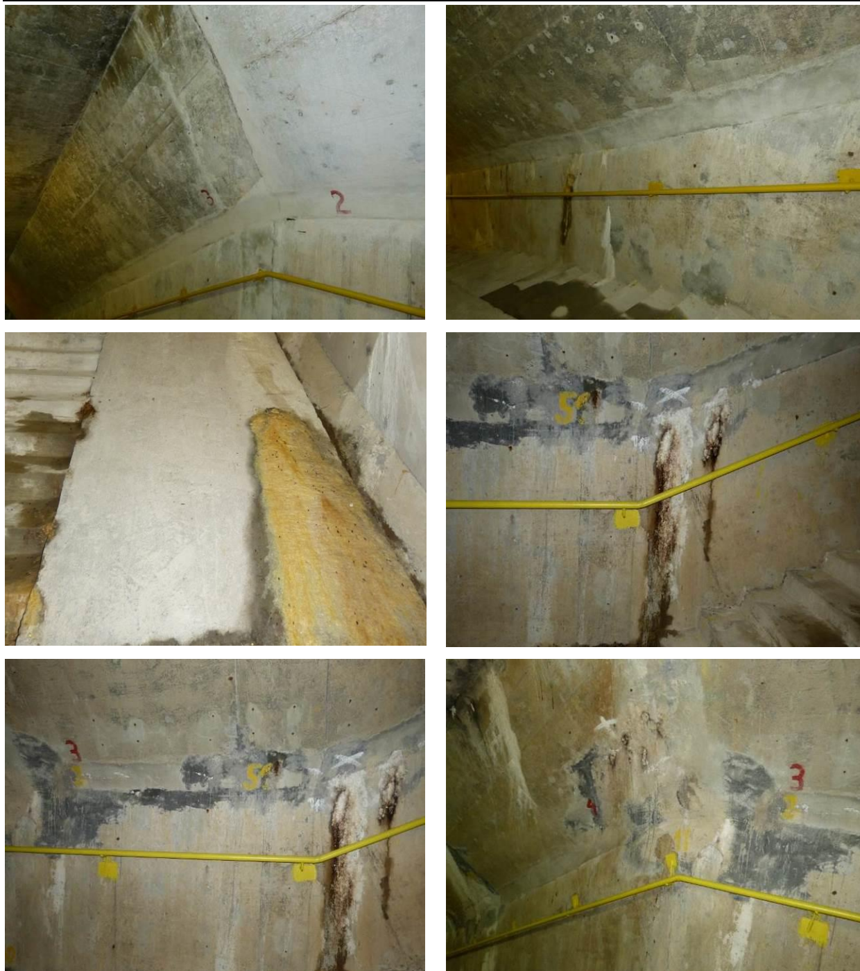
Fot. 3.3. Widok na stan techniczny sekcji nr 3 konstrukcji galerii kontrolno-zastrzykowej
