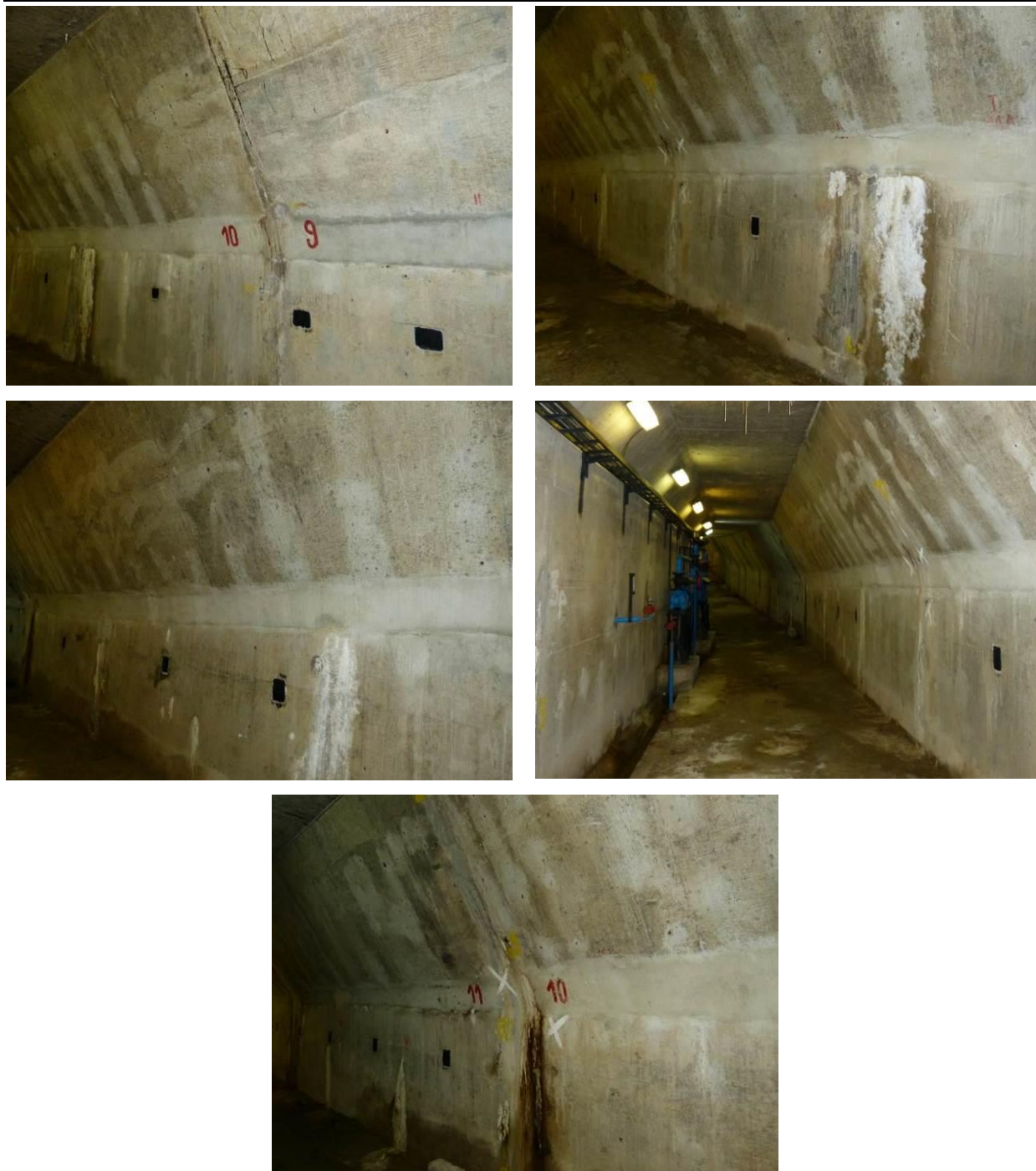
Fot. 3.10. Widok na stan techniczny sekcji nr 10 konstrukcji galerii kontrolno - zastrzykowej
