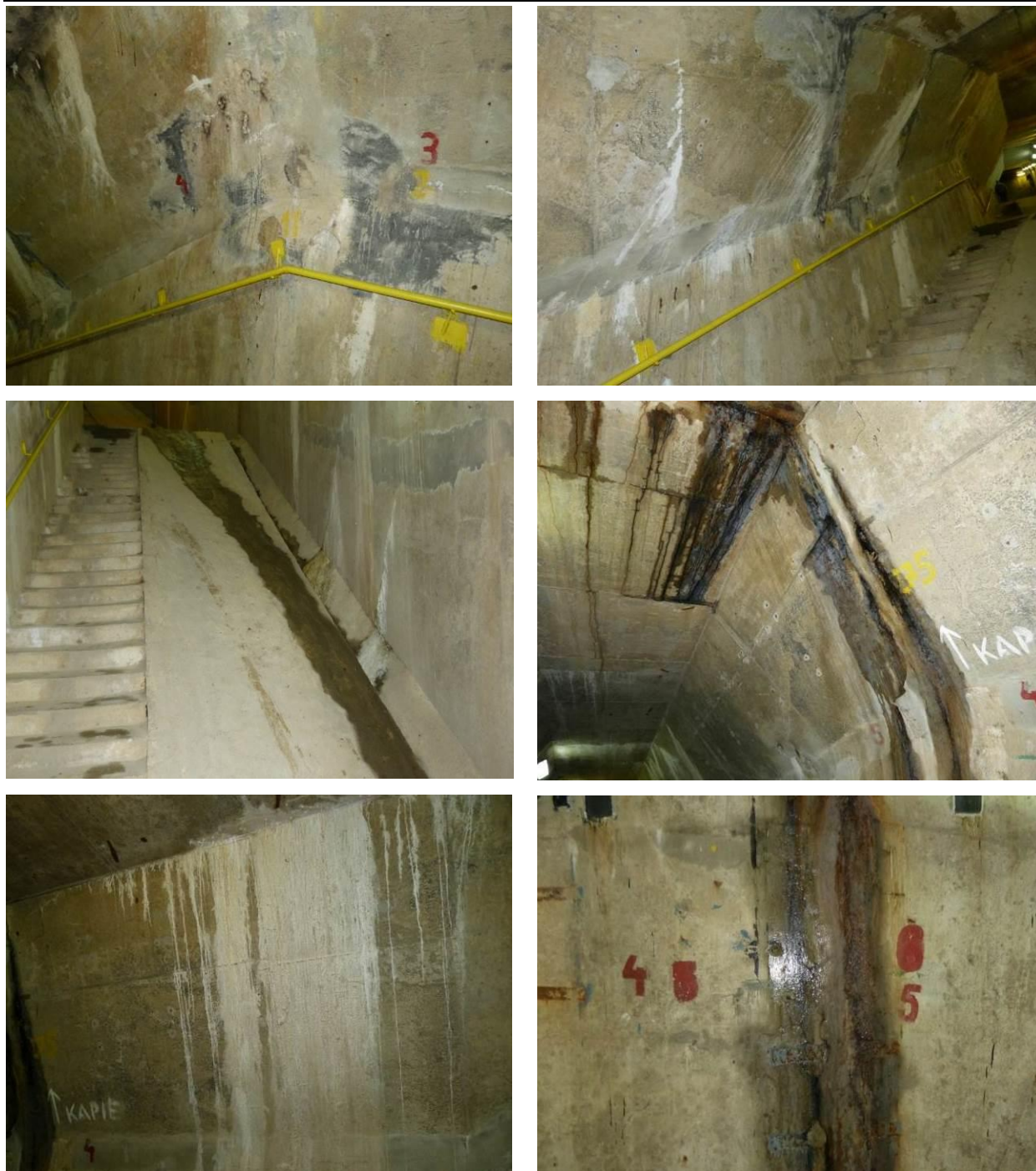
Fot. 3.4. Widok na stan techniczny sekcji nr 4 konstrukcji galerii kontrolno-zastrzykowej
