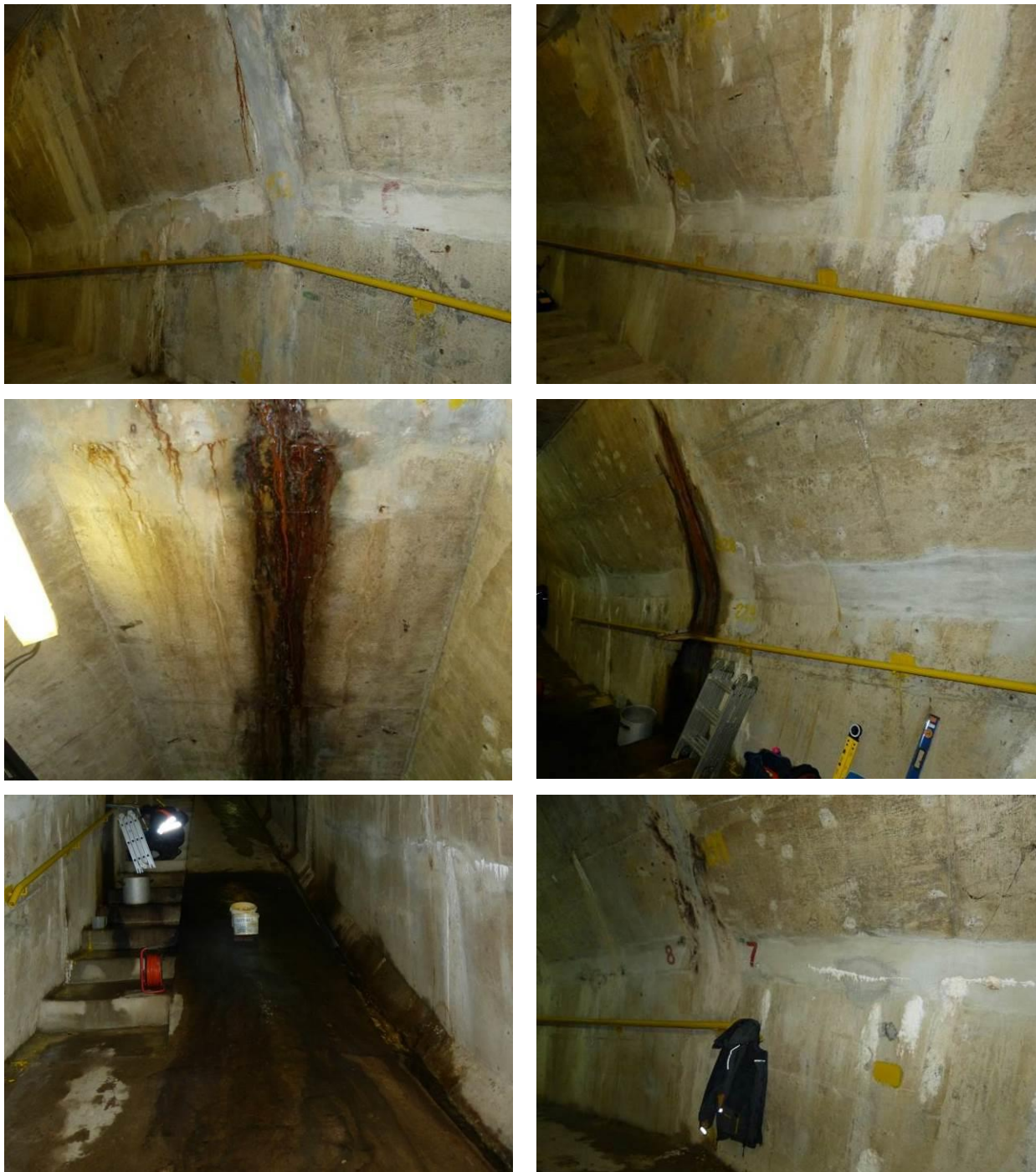
Fot. 3.7. Widok na stan techniczny sekcji nr 7 konstrukcji galerii kontrolno-zastrzykowej
