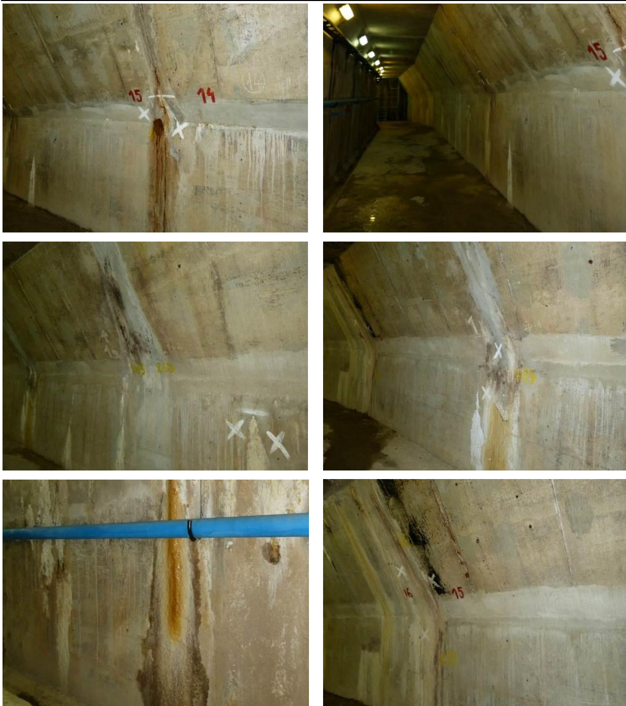
Fot. 3.15. Widok na stan techniczny sekcji nr 15 konstrukcji galerii kontrolno-zastrzykowej
