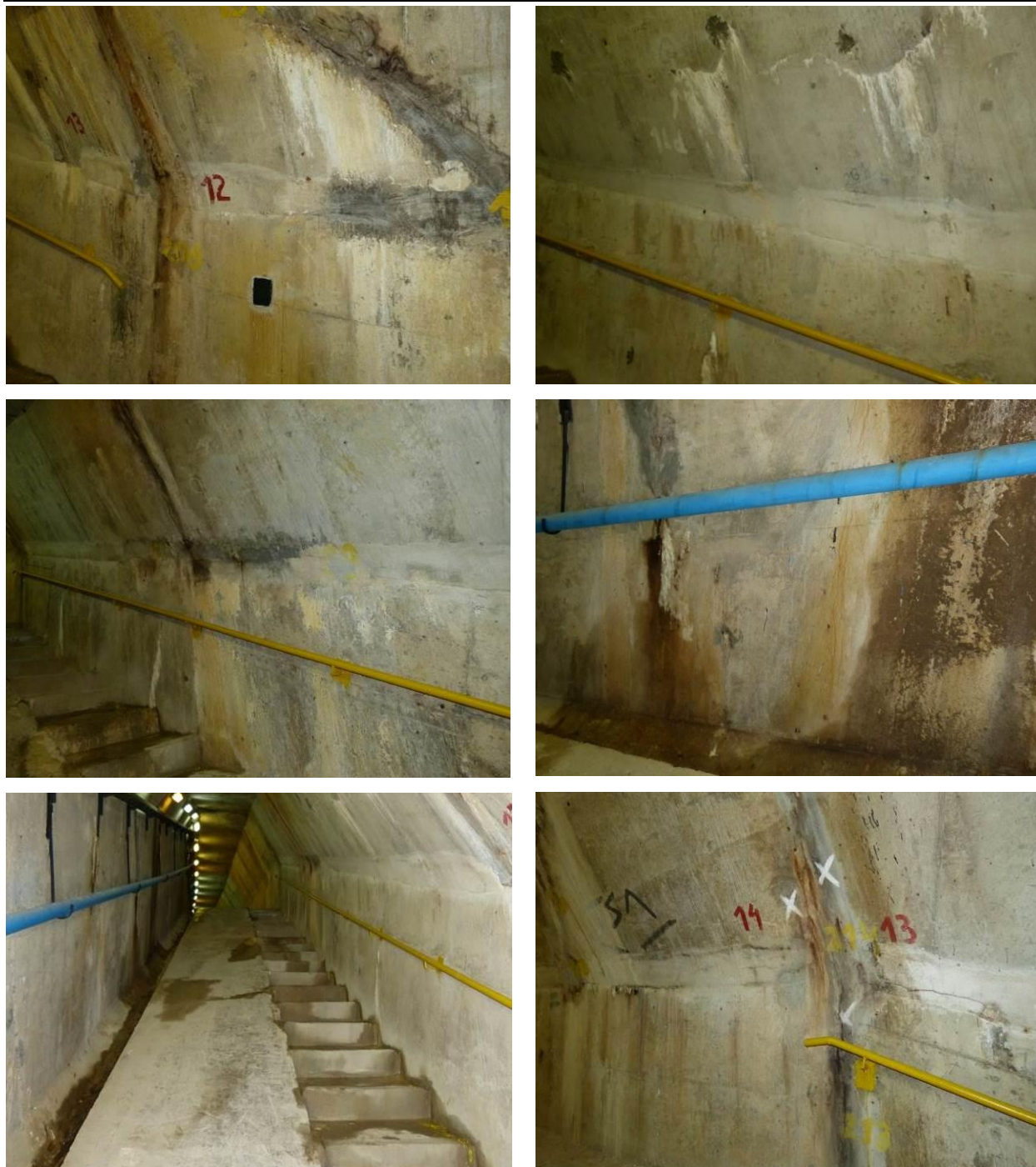
Fot. 3.13. Widok na stan techniczny sekcji nr 13 konstrukcji galerii kontrolno-zastrzykowej
