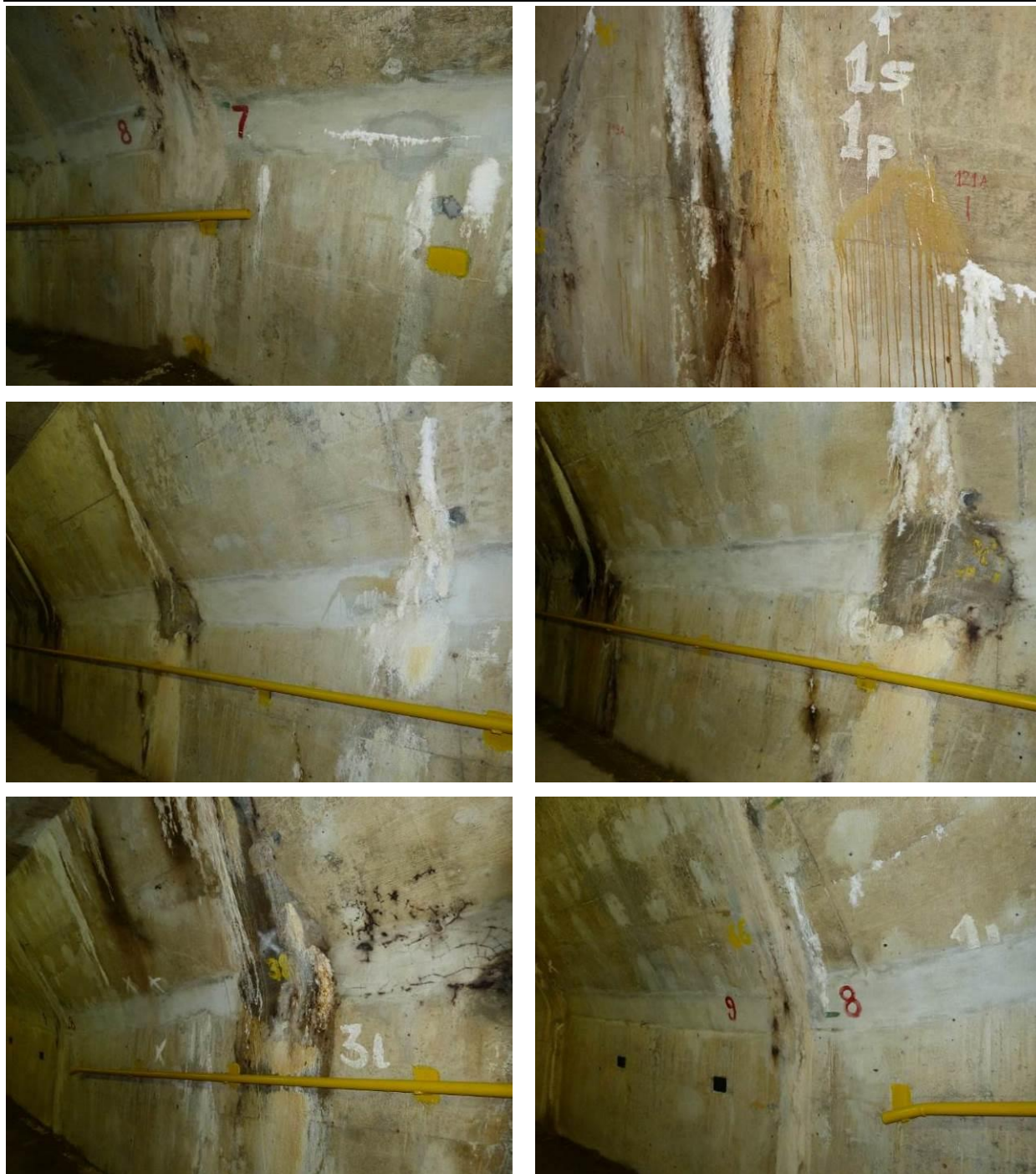
Fot. 3.8. Widok na stan techniczny sekcji nr 8 konstrukcji galerii kontrolno-zastrzykowej
