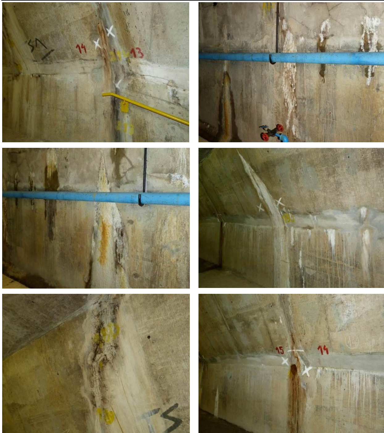
Fot. 3.14. Widok na stan techniczny sekcji nr 14 konstrukcji galerii kontrolno-zastrzykowej
