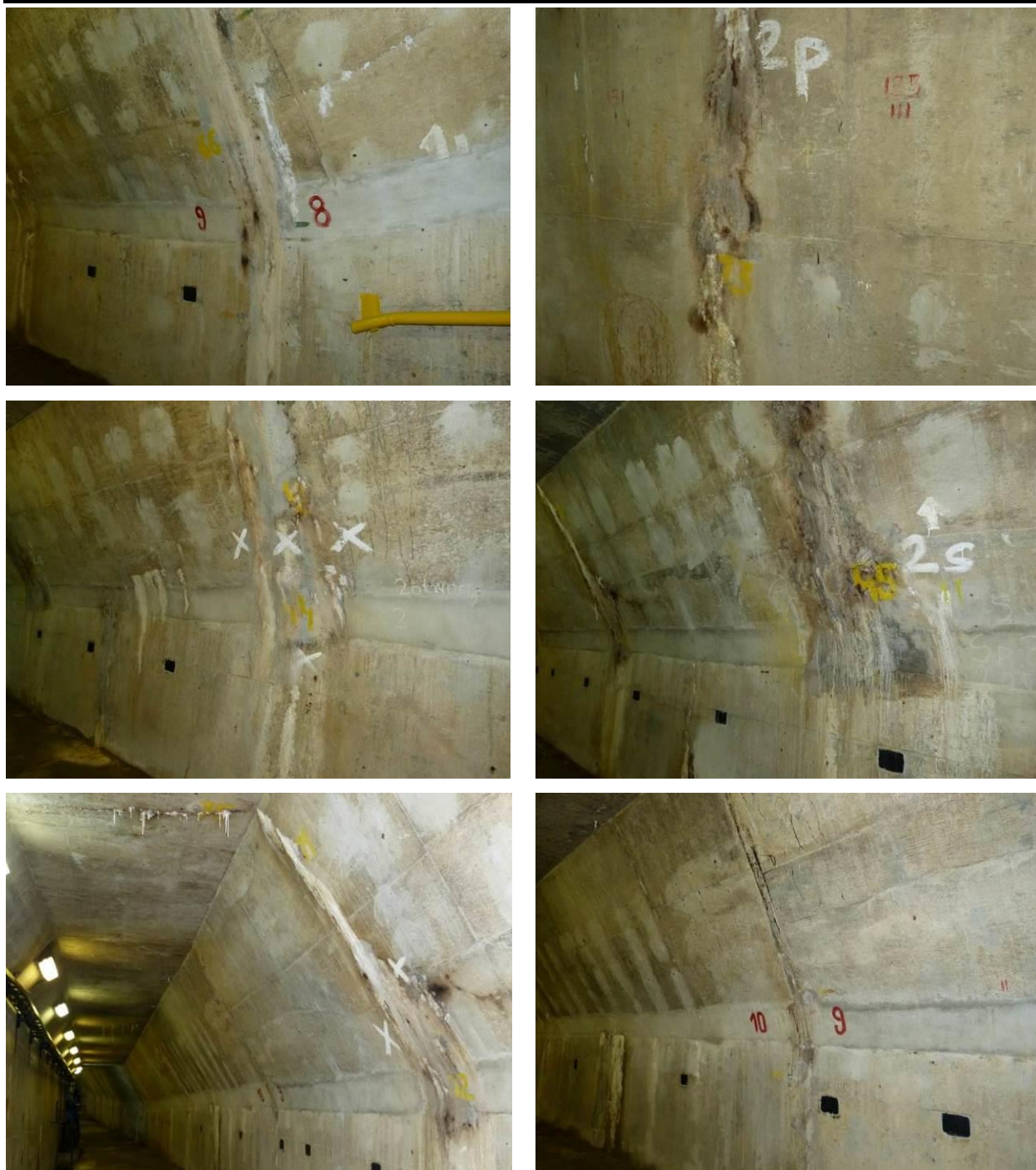
Fot. 3.9. Widok na stan techniczny sekcji nr 9 konstrukcji galerii kontrolno-zastrzykowej
